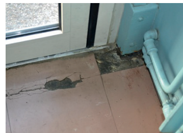
► Dalles de sol (colle et matière amiantée) dégradées
