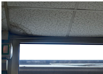
► Dalles de faux plafonds
